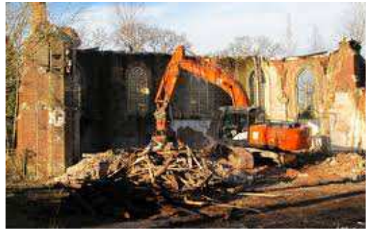
Destruction de la chapelle Saint-Bernard à Clairmarais (62)
