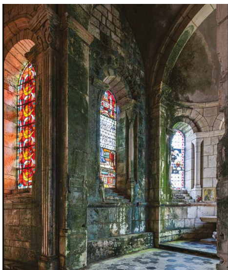
Église Notre-Dame, prieuré de La Charité-sur-Loire, dégradation par l'humidité, Nièvre.
