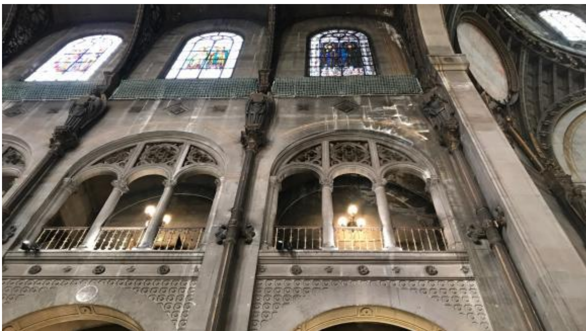
Filets de protection et taches d'infiltration sous la nef de Saint-Augustin, à Paris, le 7 mai 2019. (CAMILLE CALDINI / FRANCEINFO)
